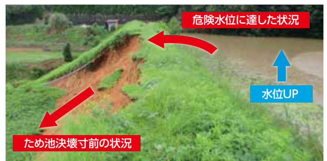
付近一帯に「避難指示」が発令された滝宮の奥池(平成30年7月 西日本豪雨)
